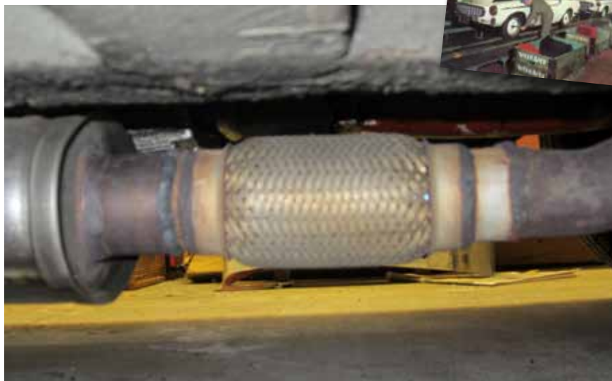
Flex-rør ved forrørssamling
