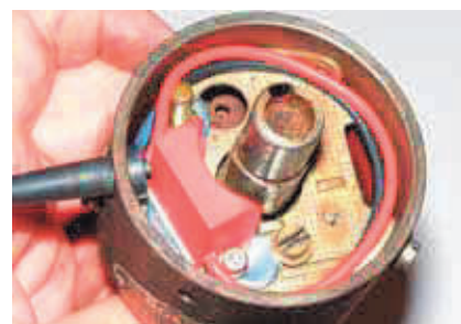
Hot-Spark modulet er monteret
